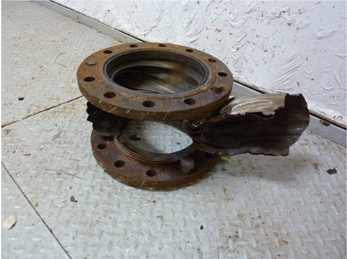
▲ Figuur 10: Het gescheurde expansiestuk na demontage (bron: Onderzoeksraad voor Veiligheid).
