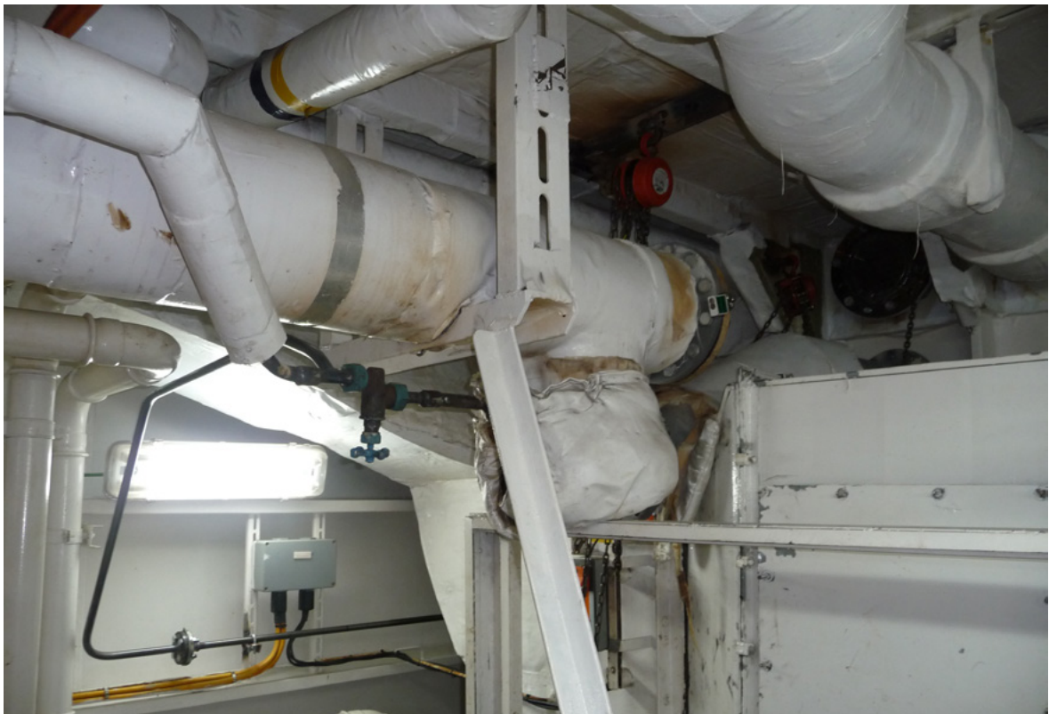
▲ Figuur 11: Stoomleidingen verpakt in isolatiemateriaal (bron: Onderzoeksraad voor Veiligheid).
