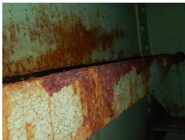
afbeelding 36: corrosie hoofdligger onder keilbouten
