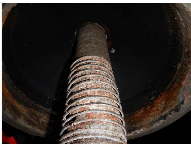
afbeelding 17: corrosie onder verzinkte draad (oost-32)
