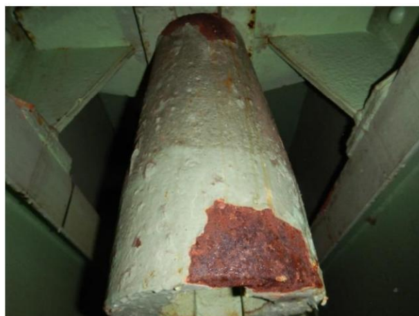
afbeelding 24: corrosie op conus (oost-32)
