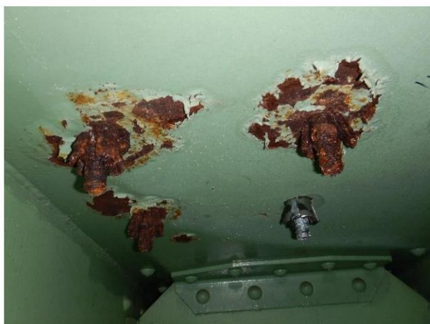
afbeelding 35: corrosie rond keilbouten
