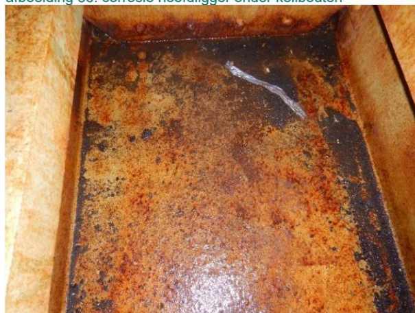
afbeelding 38: corrosie op vloer onder kabeldoorvoer
