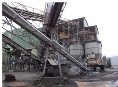
Werk-Nickenich: installatie, nadere inspectie niet mogelijk
