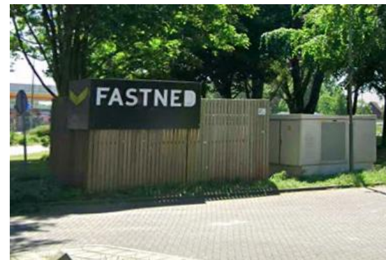
Figuur 11 Transformatorhuisje Sandelingen-Oost
