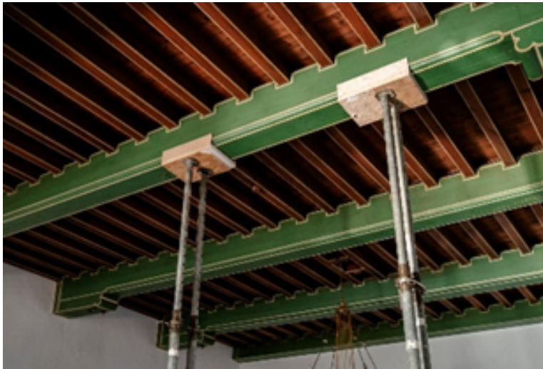
Weeskamer: ondersteuning van het plafond
