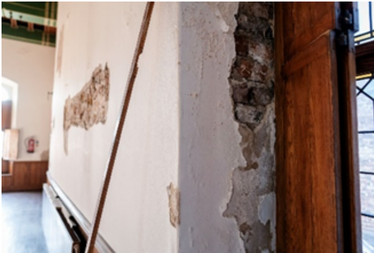
Rolzaal: vochtproblematiek bij kozijnen
