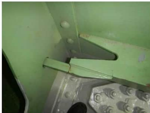
Foto 3: Voorbeeld overige schade 1.
