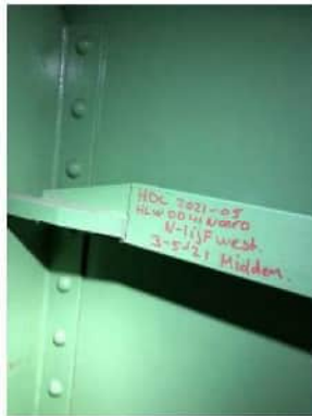
Foto 5: Overige schade 2 (t.h.v. dwarsdrager 41).
