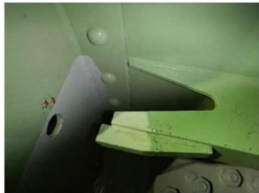
Foto 4: Voorbeeld overige schade 1.
