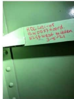
Foto 6: Overige schade 2 (t.h.v. dwarsdrager 57).
