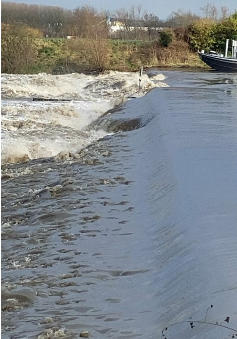
Figuur 4.12 Uitbreiding van de schade, 3 jan 24 12:16 uur.
