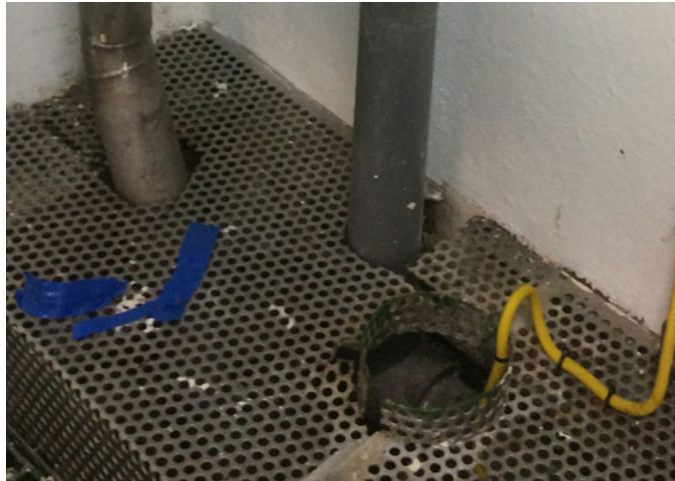
Figuur 11: Detail stuurboord lensinstallatie UK-160. (Bron: Maaskant Shipyards Stellendam)
